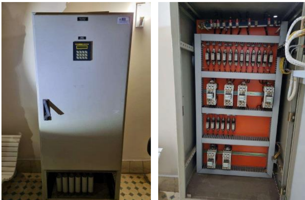
Figura 8 - Vista externa e interna do quadro do banco de capacitores
