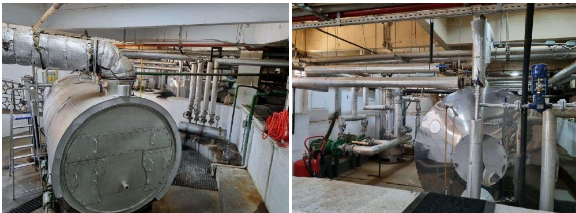
Figura 3 - Vista geral da caldeira
