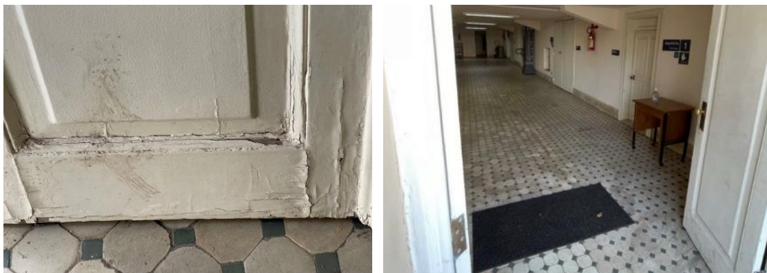
Figura 6 - exemplo de porta e piso com necessidade de revitalização
