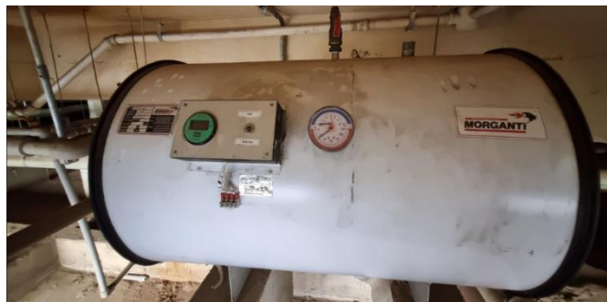
Figura 9 – Gerador de vapor
