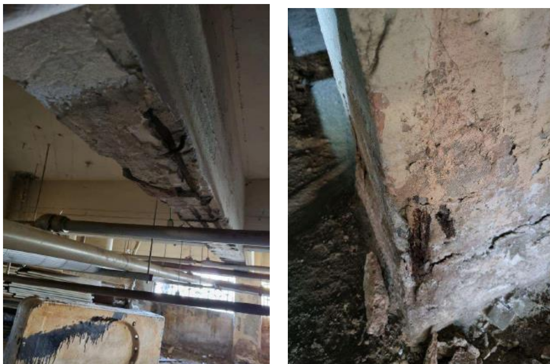
Figura 1 - registro de patologias observadas na estrutura da edificação
