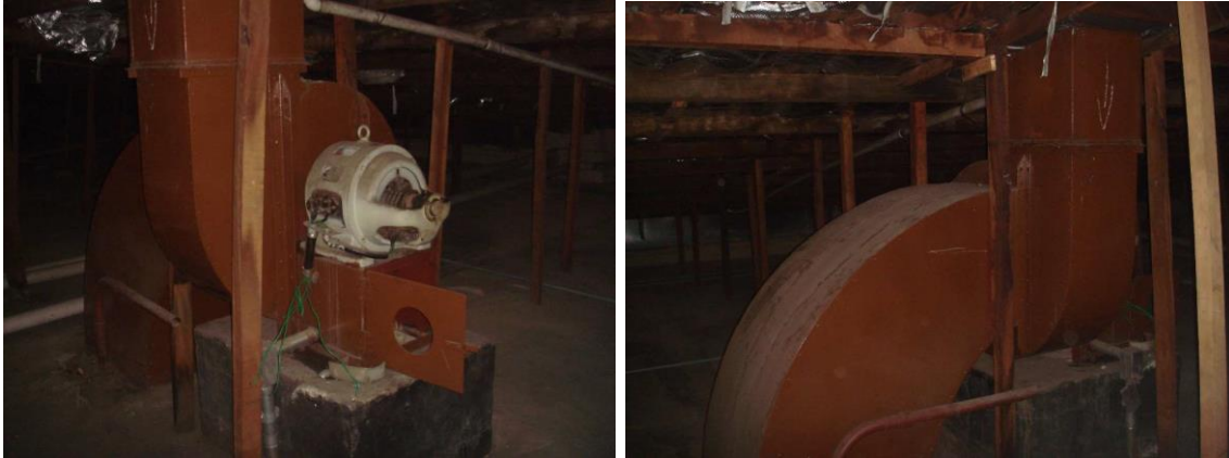
Figura 2 - Vista dos equipamentos de insuflamento / exaustão e dutos do sistema
