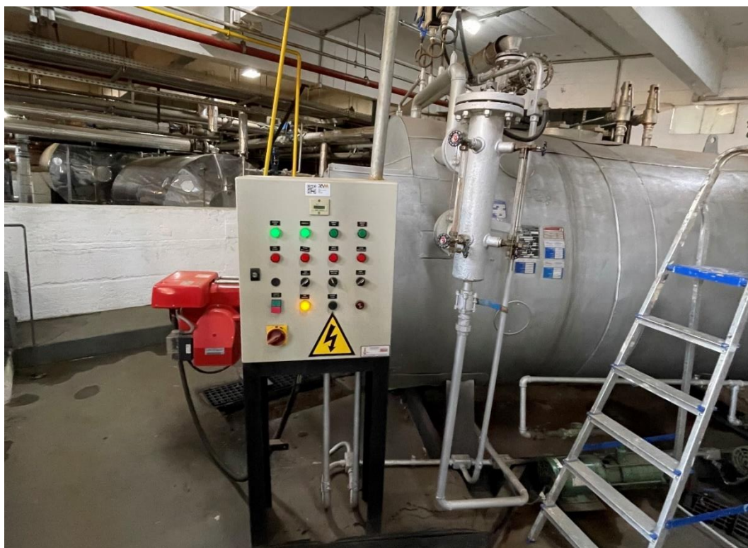
Caldeira e boilers
