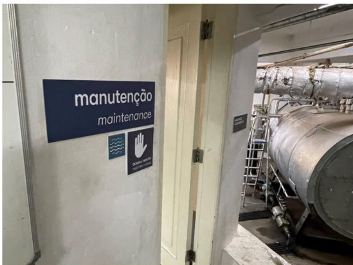
Oficina de Manutenção
